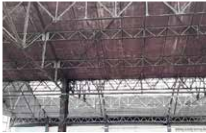
Effritement avancé et corrosion légère des peintures de charpentes sur toutes les pièces métalliques.
