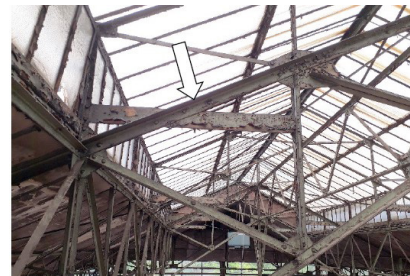
Effritement avancé et corrosion légère des peintures de charpentes
