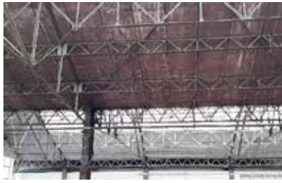
Gevorderde afbladdering en lichte corrosie van de geverfde frames bij alle metalen onderdelen.
