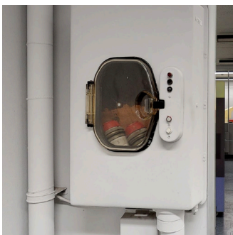
5 TERMINAL DE TRANSPORT PNEUMATIQUE / IN-EN UITVOERSTATION VOOR PNEUMATISCH TRANSPORT / PNEUMATIC-TUBE TERMINAL 100€
